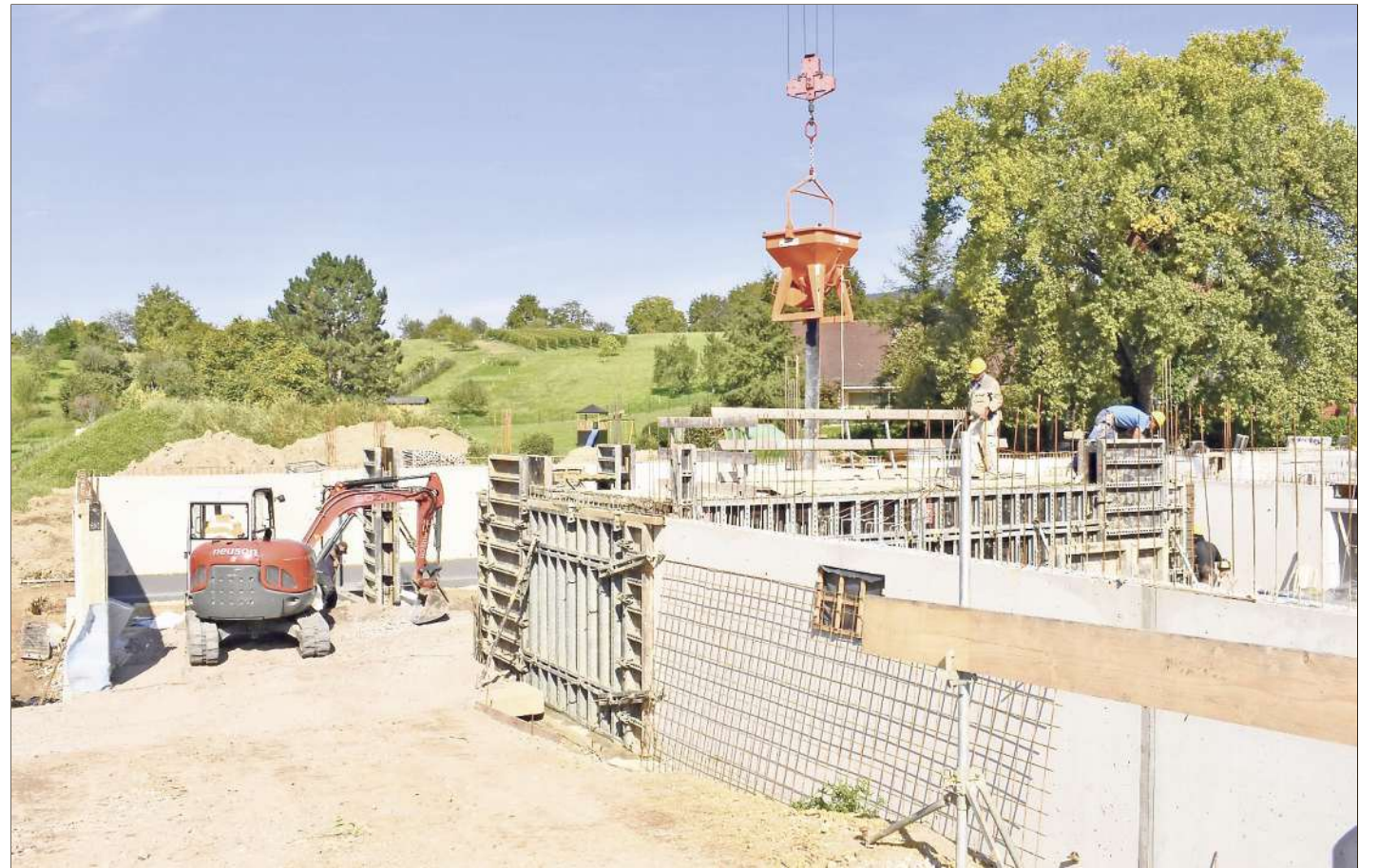
Das Erdgeschoss ist für Büros oder Arztpraxen ausgelegt. Parken kann man in einer eigenen Tiefgarage.
